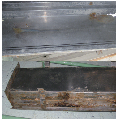
Производство икры. Год эксплуатации. Сквозная коррозия
